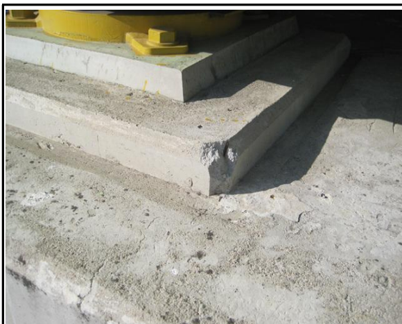
일산방향 P10-SH1 받침콘크리트 파손
