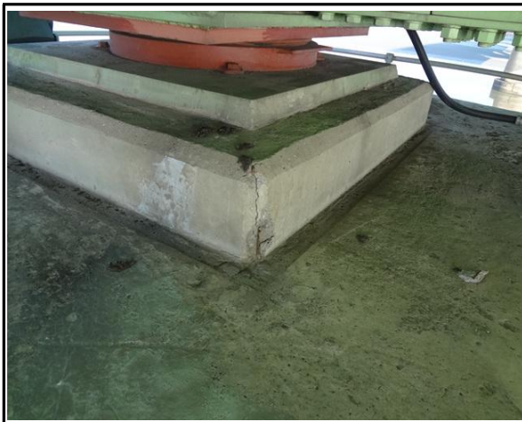
인천방향 P19-SH2 받침콘크리트 박락
