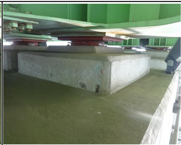
인천방향 P23-SH4 받침콘크리트 철근노출
